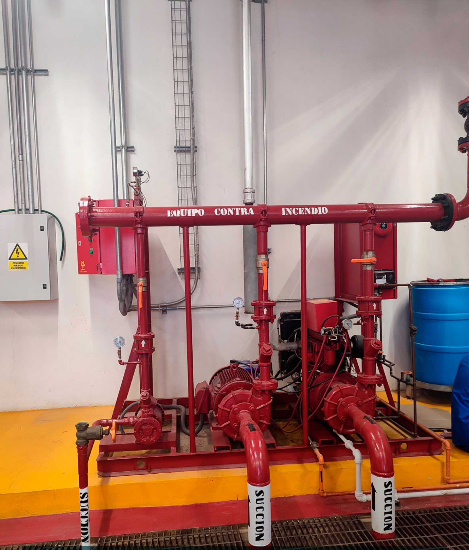
■ Redundancia de un sistema de extinción de incendios. Hospital General Regional 2, Instituto Mexicano del Seguro Social, El Marqués (Querétaro, México). Centro Colaborador MEX-35 de la OPS/OMS para Servicios de Salud Resilientes. 2021
